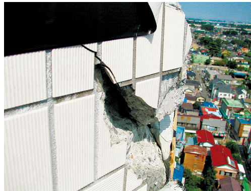
落雷による建物側面の破損
